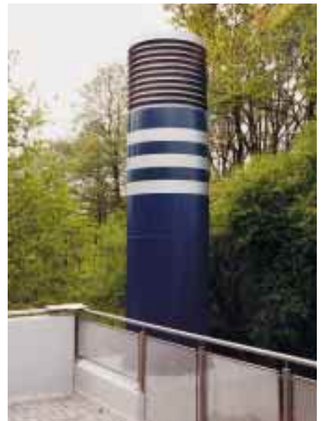
Zuluftturm für das Schwimmbad Bremervörde in stahlverzinkt-lackierter Ausführung
