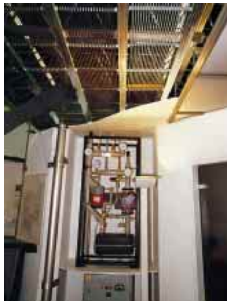
Rund 300 000 m 2 Kühldeckenfläche wurde im letzten Jahr in Deutschland installiert. Emcal hat sich auf Einheiten bis etwa 400 m 2 spezialisiert
