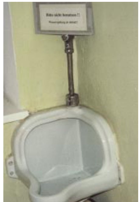
Älteres Siebbodenurinal mit defektem Druckspüler
