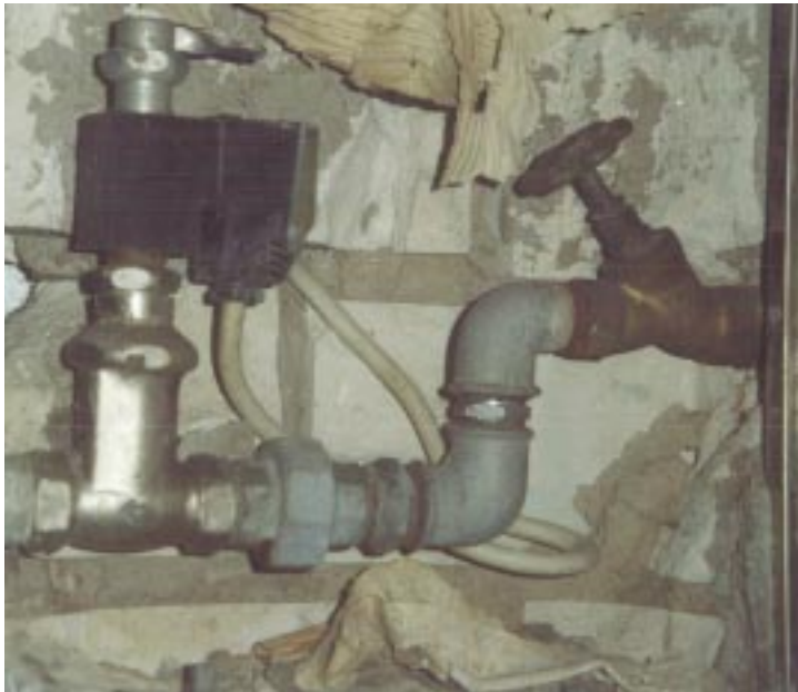
Zentral angesteuertes Magnetventil in der Zuleitung zur Urinalspülung im Hallenbad
