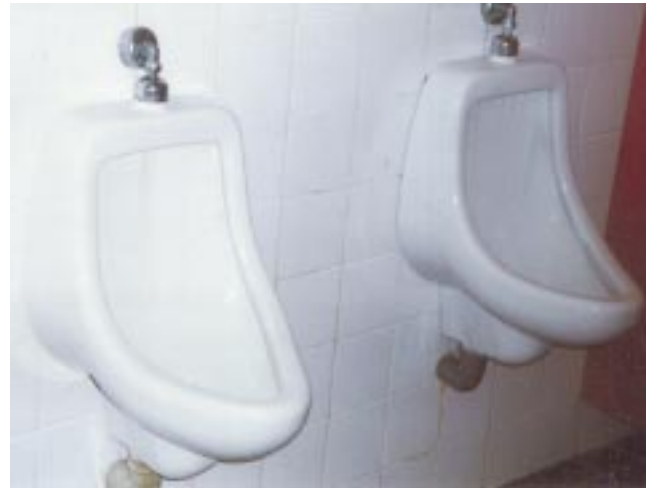
Zentralgesteuerte Urinalanlage im Hallenbad
