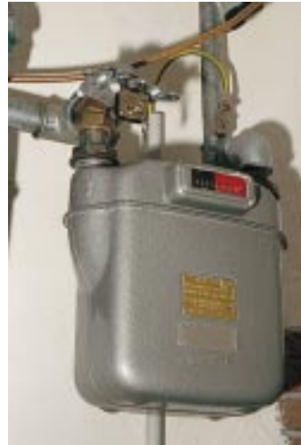
Die unbefugte Gasentnahme sowie Manipulationen lassen sich mit einer abschließbaren Gashahn-sicherung einschränken [2]
