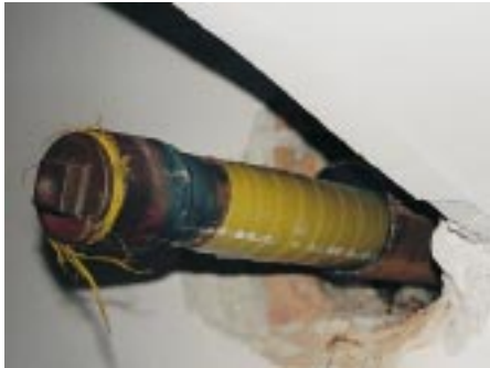
Leider gelegentlich immer noch zu sehen: Der ungesicherte Stopfen als provisorischer Verschluss der Gas-Hauseinführung – eine „Einladung“ zu Manipulationen
