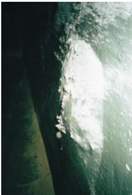
Bild 4 Luftblase in einem alten Anstrich. Mögliche Ursache ist durch die Wand diffundierende Feuchtigkeit
