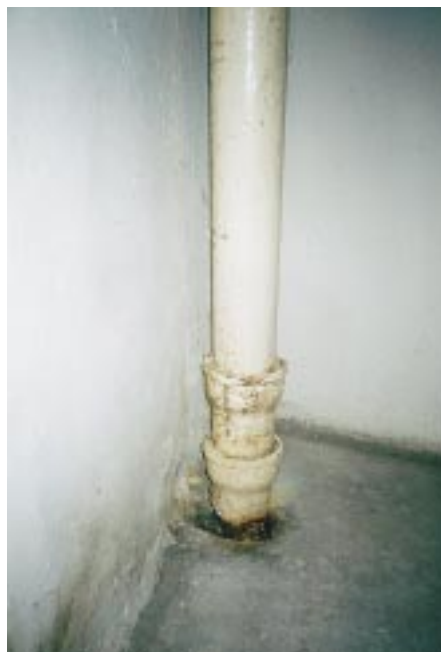
Bild 8 Die Durchführung von Leitungen darf nicht im Bereich der Auffangwanne – wie hier dargestellt – erfolgen. Mögliche Lösung: Abmauerung der Abwasserleitung und anschließender Anstrich mit öldichter Farbe
