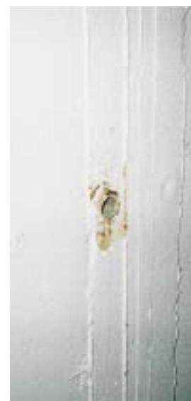
Bild 6 Nicht verschlossene Öffnung von Schalungsbefestigungen. Im Ernstfall kann die Auffangwanne ihre Aufgabe nicht erfüllen
