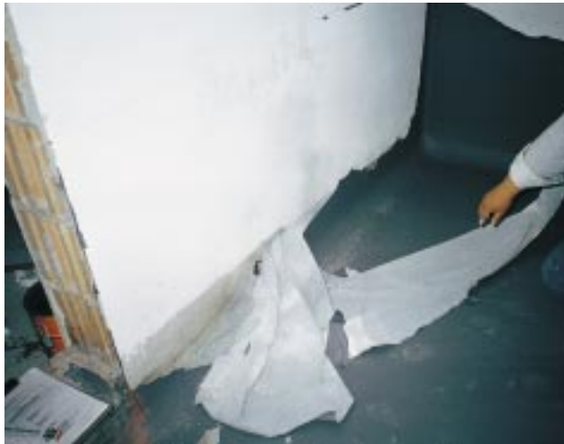
Bild 5 Untergrund wurde nicht richtig ausgeführt. Folge: der öldichte Anstrich blättert von der Wand ab
