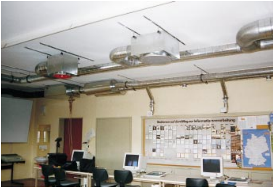
Die Deckeninstallation der beiden Anlagen. Im Vordergrund zwei Luftauslässe mit Absperklappen, an der Wand Luftein- und -auslässe
