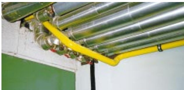
Die beste Gasleitungsbefestigung ist chancenlos, wenn im Brandfall andere Gebäudeteile auf die Leitung stürzen können
