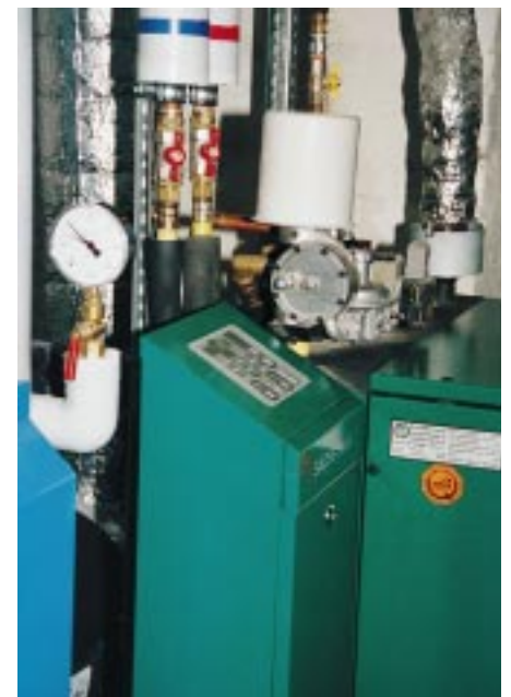
Das Blockheizkraftwerk, das die Wärme in ein Nahwärmenetz liefert, verfügt über 5,5 kW elektrische und 12,5 kW thermische Leistung
