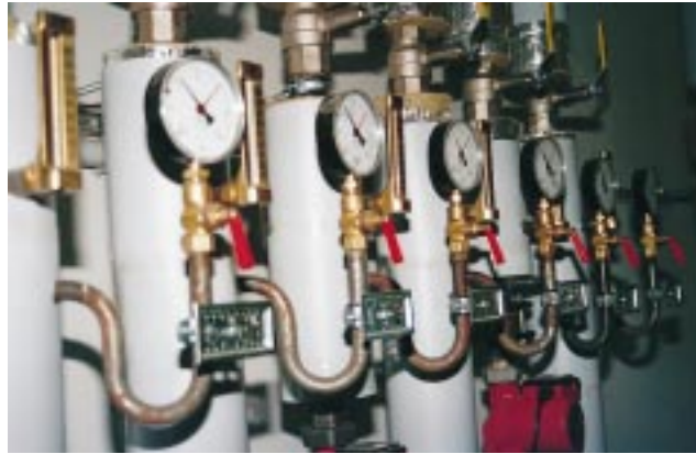
Wärme und Strom werden sowohl an private wie auch an gewerbliche Abnehmer abgegeben
