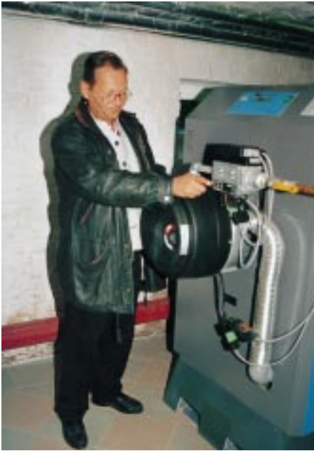
Neben dem BHKW unterstützen zwei leistungsfähige Wärmeerzeuger das Nahwärmenetz
