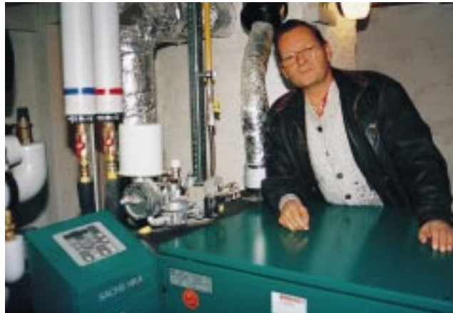
Geschäftsführer Stange von B.R.A.S.S.T. Bau, die auf dem Firmengelände ein BHKW betreibt: Auf Nachfrage nach Wärmelieferung sind wir gut vorbereitet
