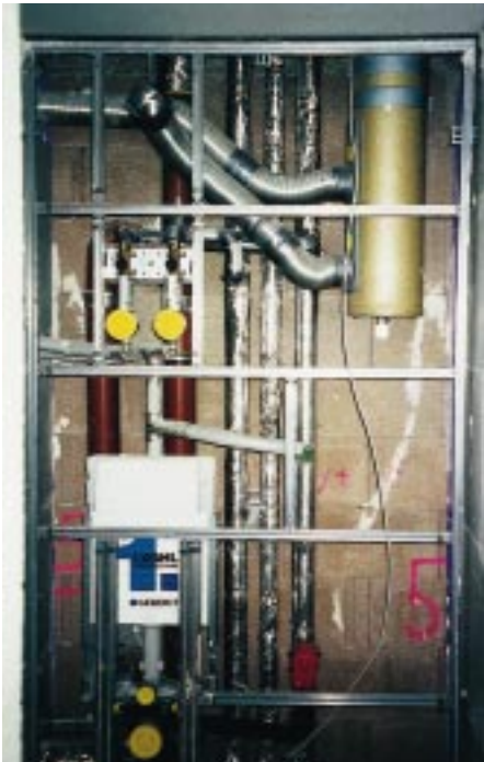
Unbeplanktes VWI-Schachtmodul der untersten Etage, mit den Anschlüssen für Küchen- und Badentlüftung, dessen Brandabsperren und den Mini-Schalldämpfern...
