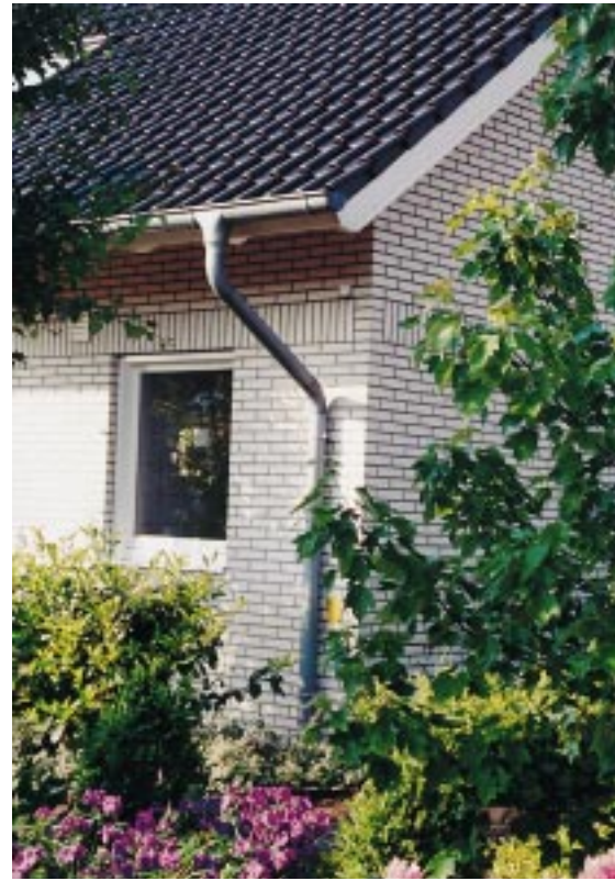
Dachentwässerung mit genormten Fertigteilen in der Oberflächenqualität „vorbewittert“
