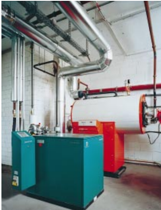
Die HKA ersetzt meist nicht die bestehende Heizungsanlage, sondern dient zur Grundlastabdeckung des thermischen und elektrischen Bedarfs
