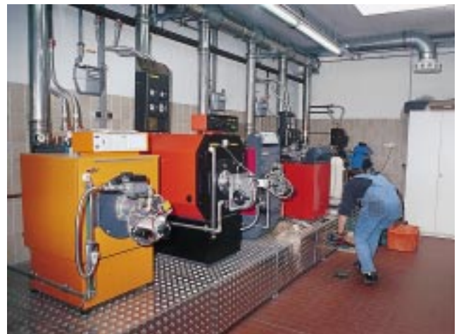
In der neuen Zentralheizungswerkstatt lernen die Lehrlinge Kessel und Brenner verschiedener Hersteller kennen
