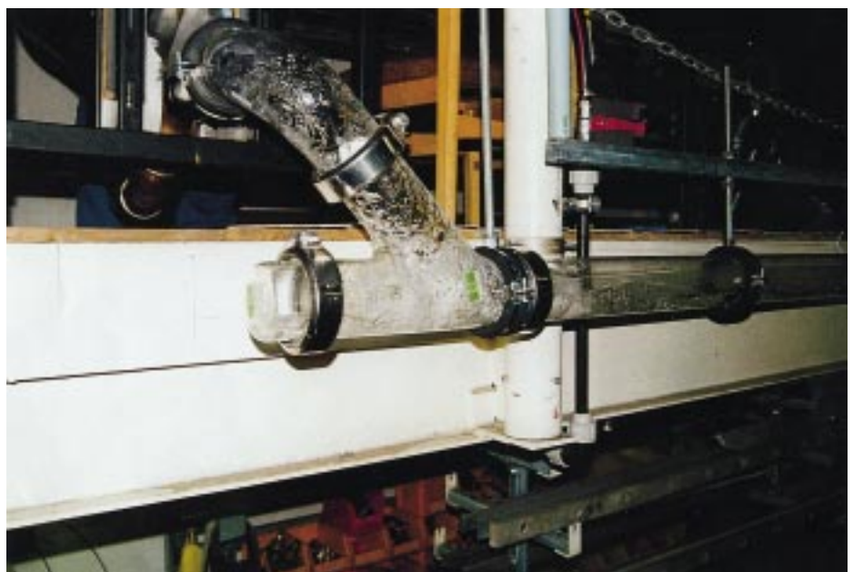
Bild 2 Strömungsübergang vom Klosettabgang in den Abzweig einer Anschlusion. Im Abzweig führt eine rückstauende Wasserverteilung zu einer Minderung des Abflußvolumenstromes
