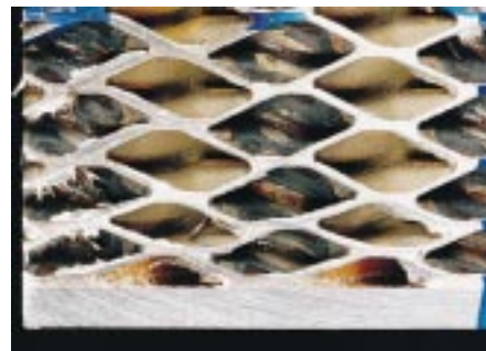
Auslöser für zahlreiche Schäden sind die kupfergelöteten Plattenwärmetauscher
