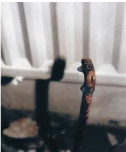
Typischer Schaden einer Heizungsleitung durch Frosteinwirkung
