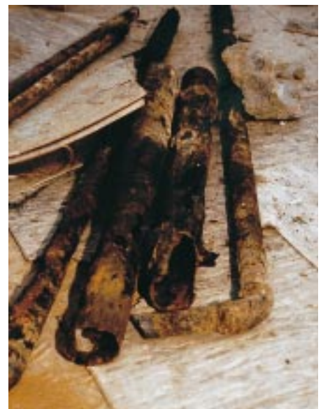
Totalschaden an einem Leitungssystem durch unsachgemäße Verlegung im Erdreich
