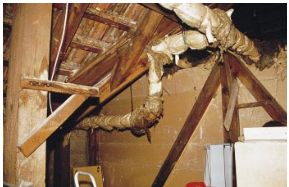
Die unfachmännische Wärmedämmung der Wasserleitung im ungenutzten Dachboden führt über kurz oder lang zum Frostschaden
