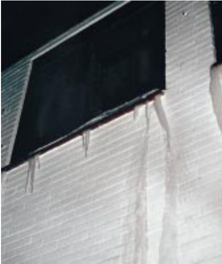
Innerhalb eines Arbeitstages entstand dieser Schaden. Ursache: ein auf Lüftung angekippertes Fenster und eine abgestellte Heizung
