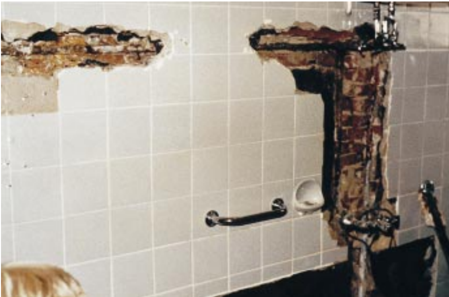
Umfangreiche Stemmarbeiten und zerstörte Fliesen. Dabei wäre beispielsweise eine im Nachbarraum neu verlegte Leitung kostengünstiger gewesen
