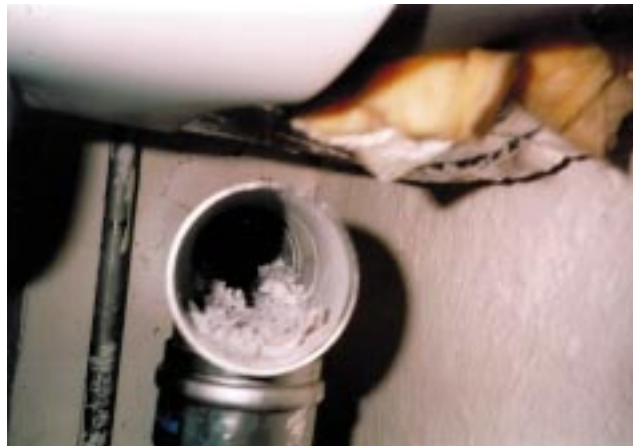
Bild 1 Ablagerungen in Verbindungsstücken aus Aluminium
