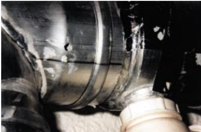
Bild 3 Perforationen an Aluminiumabgasleitung
