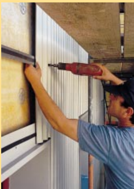
. . . Deren Befestigung erfolgt durch Blechschneidschrauben auf der Unterkonstruktion, wobei eine ausreichende Hinterlüftung verbleibt
