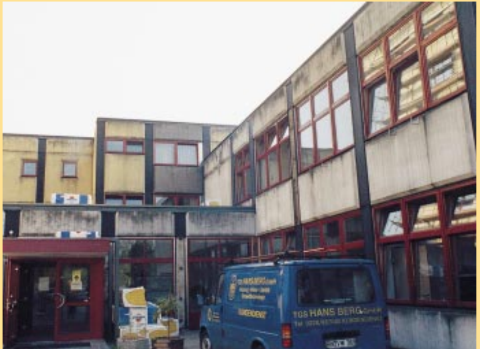
Nach über 20 Jahren sahen die Betonfassaden der Polizeiausbildungsstätte nur noch wenig ansprechend aus
