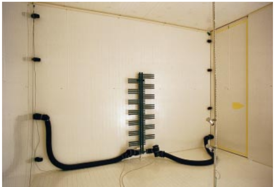
Eine vollautomatisch arbeitende Prüfkabine zur Ermittlung der Wärmeleistung von Heizkörpern nach EN 442 errichtete Zehnder im schweizerischen Gränichen
