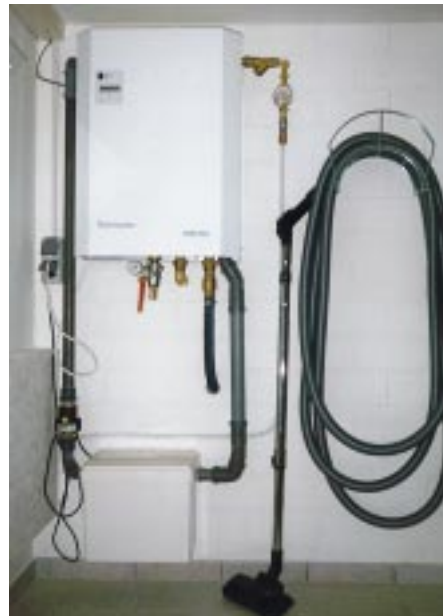
Zentralstaubsaugersystem und Regenwasserzentrale zum unterirdischen, 6500 Liter fassenden Betonwassertank mit beruhigtem Wasserzulauf sowie Wirbelfeinfilter
