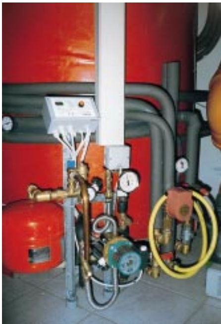
2000-Liter-Solarschichtenspeicher mit Regelungssystem
