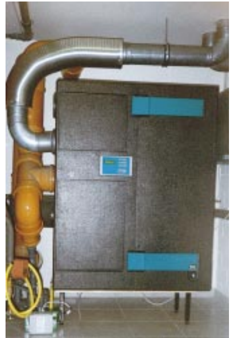
Lüftungszentrale zur kontrollierten Be- und Entlüftung mit integrierter Wärmerückgewinnung, Pollenfilter und vorgeschaltetem Erdwärmetauscher
