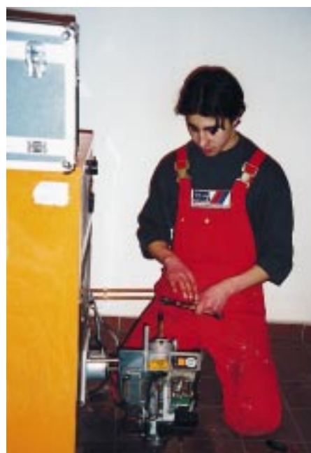
... während sich beispielsweise die Wartung eines Ölkessels oftmals systematisieren läßt
