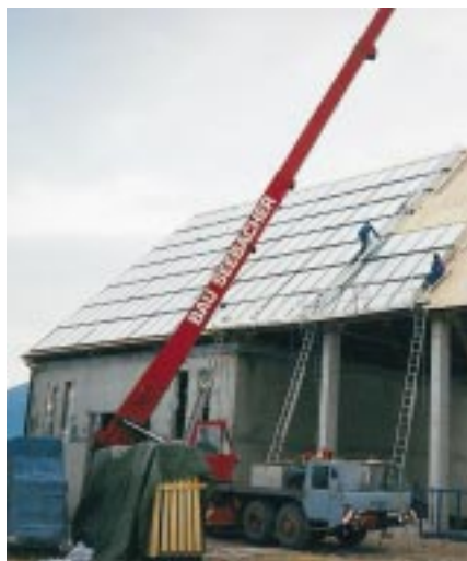
Mit dem Kranwagen-Service von Sonnenkraft geht die Montage der Indachkollektoren „IMK“ rasch über die Bühne
