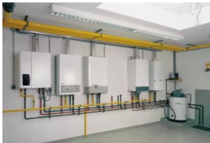
Blick in den GaSiTec-Schulungsraum mit verschiedenen Brennwert-Gasgeräten der führenden Hersteller
