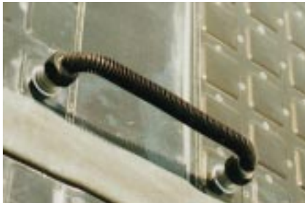
Mit Wellrohren aus Cr/Ni-Stahl sind die Absorber untereinander verbunden . . . [4]
