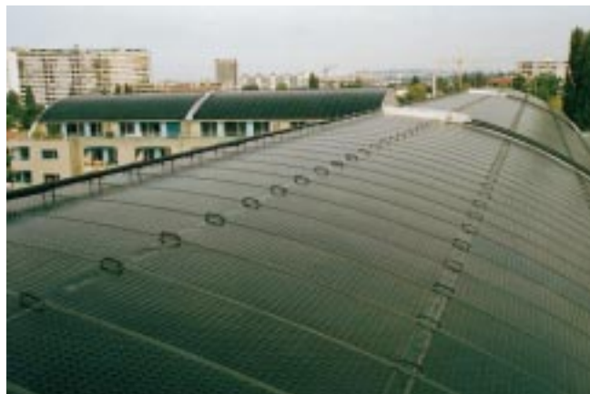
Die Kollektoren sind als Kissenabsorber aus Chrom-Nickel-Stahl 18/8 gefertigt [4]
