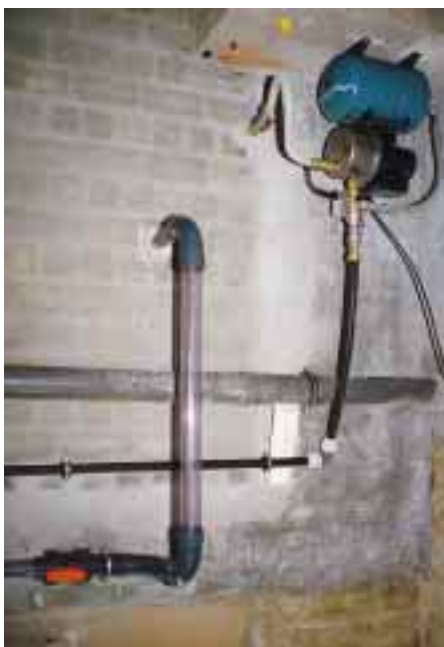
Inzwischen wurde von weiteren Schülern die Druckpumpe aufgestellt, mit der das Regenwasser in die Brauchwasserleitung eingespeist wird...
