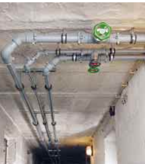
... besteht das gesamte Leitungsnetz einschließlich Ventilen aus dem starren Kunststoffsystem
