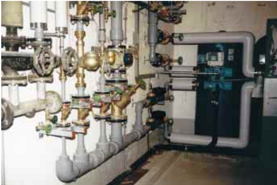
Bis auf wenige Ausnahmen in der Zentrale ...
