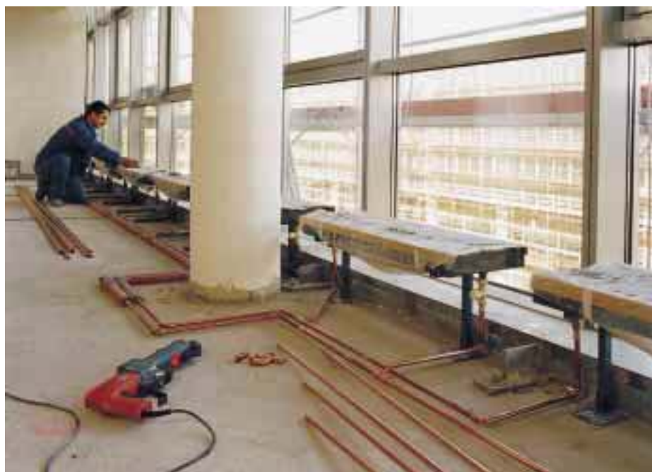
Heizungsanbindeleitungen aus Sanco-Kupferrohren mit Preßfittings der Marke profipress. Die Umführung der Leitungen um eine Säule bietet die Möglichkeit zur Aufnahme der Wärme-dehnung . . .
