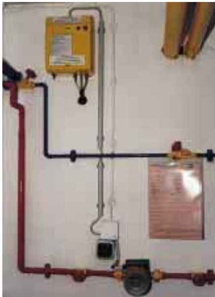
Die Datenermittlung erfolgt über Sensoren an den entsprechenden Meßstellen wie Vor- und Rücklauf (l.) oder Umwälzpumpe...
