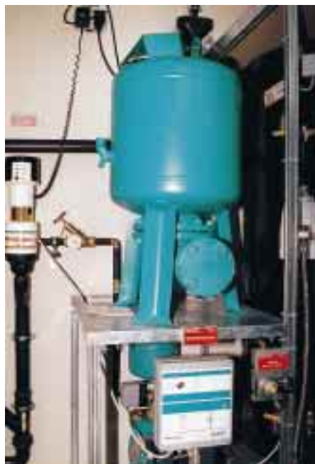
Schonender Umgang mit Ressourcen: Die Toilettenspülung wird mit Regenwasser betrieben
