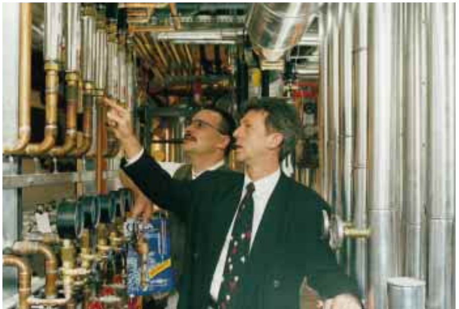
Insgesamt sieben verschiedene Wasserzuleitungen für Labore und Sozialräume im Kaltwasserbereich galt es einzubinden
