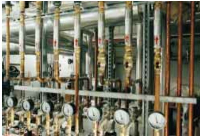
Für die Behandlung im Bereich der Warmwasserkirkulation wird nach der Umwälzpumpe ein zweites, kleineres Gerät installiert
