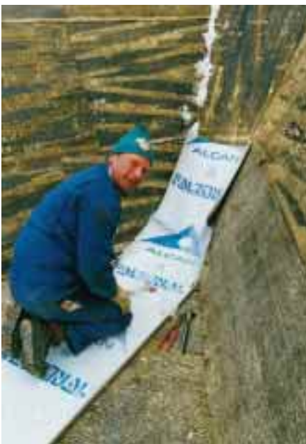
Rudolf Maierhofer bei einer der schwierigen Detailausbildungen, hier am Übergang vom flachgeneigten Dach zur steilen Kehlfläche des Hauptdaches
