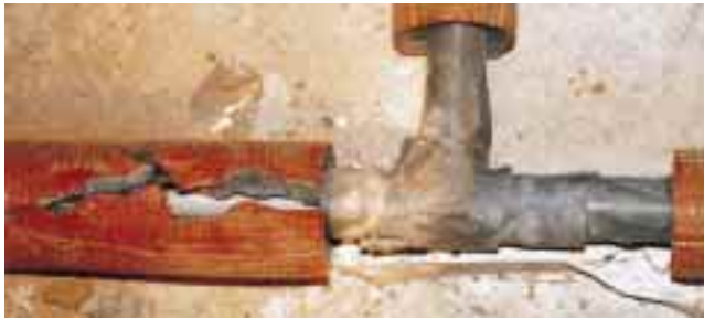
... Geschäumte Dämmhülsen mit ungeschützter Oberfläche können im rauen Baustellenbetrieb leicht beschädigt werden
