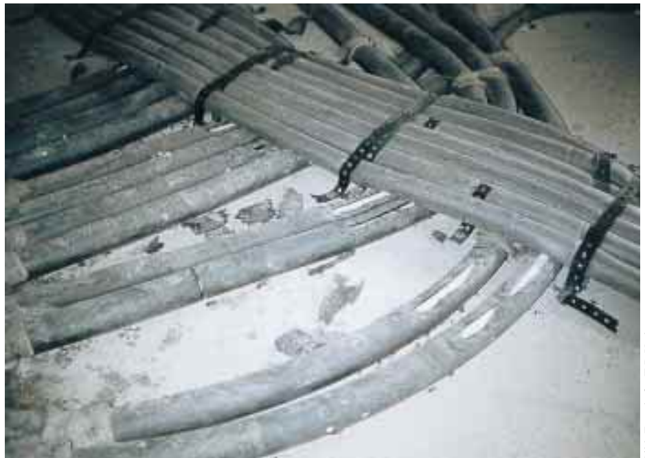
Durch eine große Anzahl kreuz und quer verlegter Rohrleitungen sind Estrichschäden und Trittschallmängel vorprogrammiert . . .
