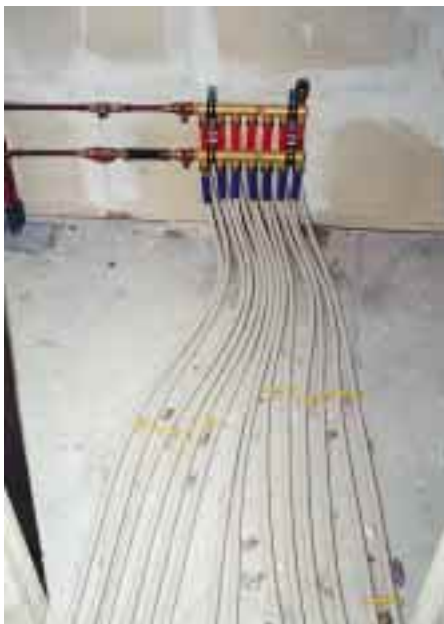
... Außerdem können Lücken zwischen unkoordiniert verlegten Rohr-in-Rohr-Systemen vom Estrichleger oft nur mit Schüttungen ausgefüllt werden
