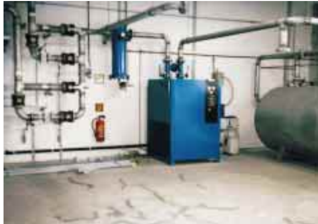
Druckluftstation mit Verteiler, Filter, Trockner und Druckluftbehälter (v.l.) außerhalb des schallgedämmten Verdichterraumes
