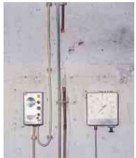
Abmontiert und abgeklemmt: Die neue VAwS bedeutet in vielen Fällen das Aus für Rücklaufleitungen und Dauerlaufpumpen
