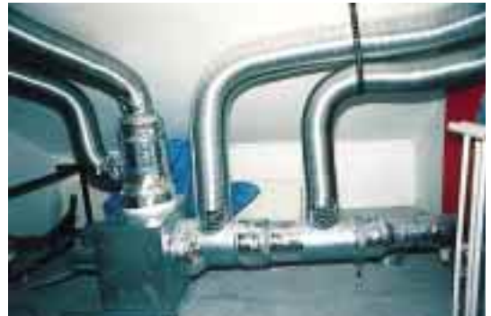
Flexrohr erhöht den Stromverbrauch und verschmutzt sehr schnell. Wenn Flexrohr sein muß, dann möglichst kurz und einfach verlegen
