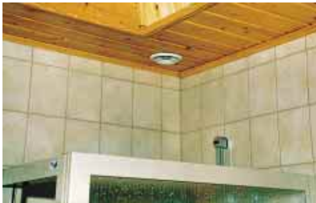
Abluftventil optimal oben über der Dusche angeordnet
