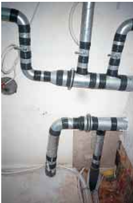
Lage, Material und Dimensionierung des Kanalnetzes sind entscheidend für die Effizienz der Anlage
