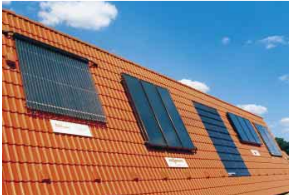
Auf dem Dach des Solarhauses präsentierten die an der Initiative beteiligten Hersteller ihre Kollektoren-Kollektion (in der Mitte das Solarstrom-System)
