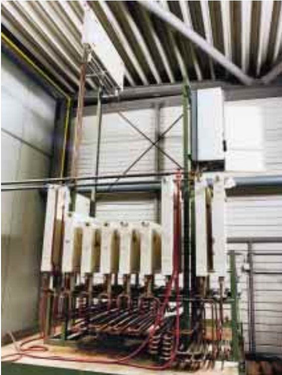
Bild 3 Versuchsaufbau bei Kermi in Anlehnung an eine Kundenanlage. Dem Original nachempfunden wurden die Längen der Anschlußleitungen und die Montagehöhen der Heizflächen
