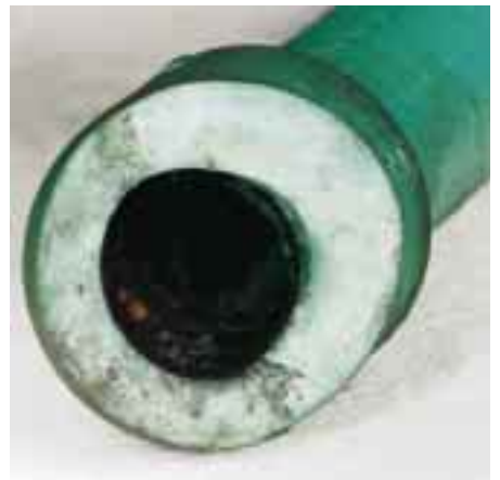
Bild 2 Ablagerungen vor einer Querschnittsverengung im Rohrnetz einer reklamierten Anlage
