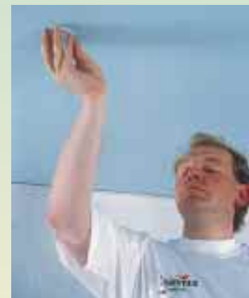
11 Nach dem Ankleben des Verstärkungsringes (Lampenauslaß) wird die Folie im Inneren ausgeschnitten
