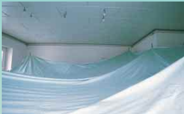
5 Blick in die Decke vor dem Einspannen; die Raumluft wurde per Gasheizer erwärmt
