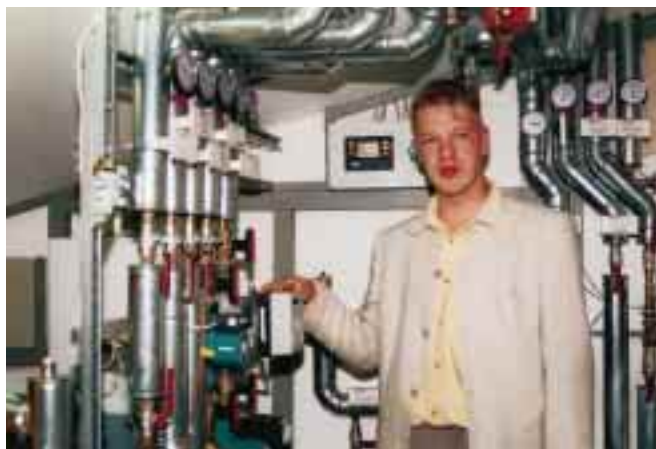
Unter dem Dach hat die Technik Platz gefunden
