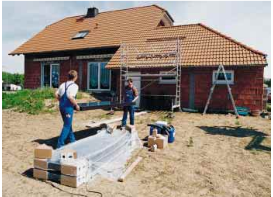
Bild 1 Solarpakete erleichtern die Arbeit des Heizungsfachmanns
