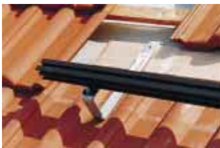
Bild 4 Bei der Auf-Dach-Montage eines Flachkollektors werden speziell auf die Dachpfannen abgestimmte Dachklammern auf Dachlatten montiert
