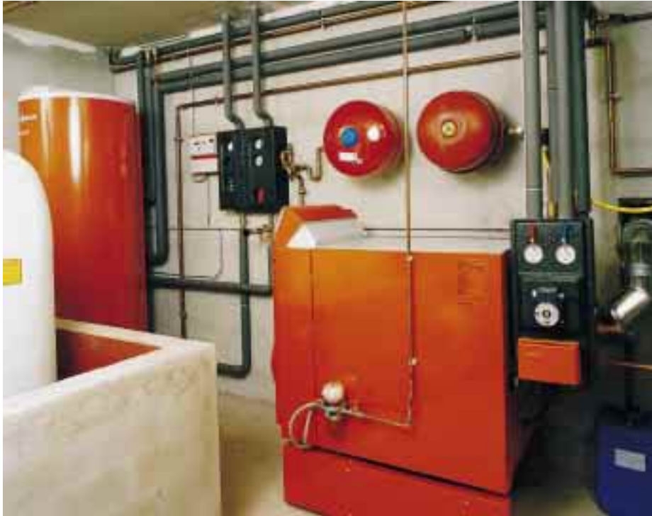
Bild 13 Blick in den Heizraum mit Heizkessel, Heizkreisverteilung, Speicher-Wassererwärmer, Regeleinheit und Pumpstation
