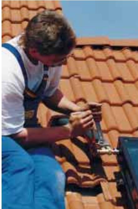
Bild 10 Über flexible Anschlußrohre werden die Kollektoren mit dem Heizsystem verbunden
