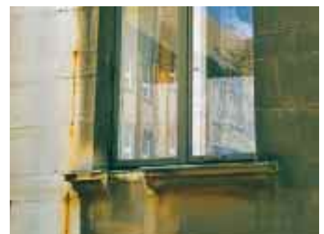
Mit der neuen Heizung verschwand auch die Abgas-/Zuluftöffnung des alten Wandheizgerätes. Der Verlust der Fensterbank ist leider nicht umkehrbar (ZHD, Eckermann)
