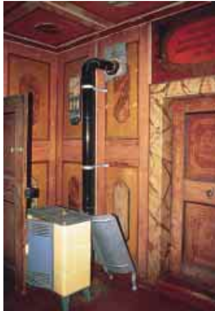
Substanzverluste durch Heizungen haben nicht immer so deutliche Ursachen (ZHD, Schaaf)
