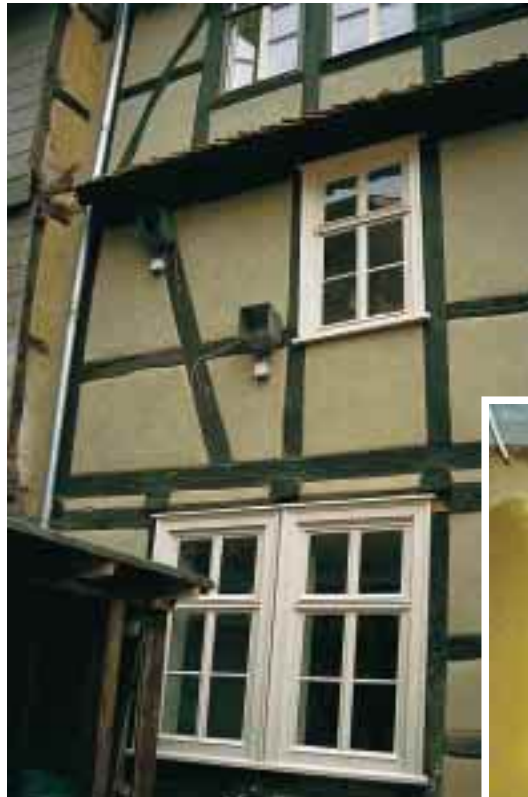
Das Lohgerberhaus erhielt eine äußere Meßinstallation (o.) sowie Feuchte- und Temperaturmeßstellen auf der Innenseite. Die Lage der Temperierrohre ist durch den frischen Lehmputz erkennbar
