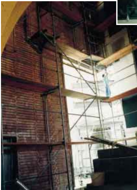
Bild 27 „Hypoplan“-Wandheizung als wasserführendes Unterputzsystem: Einmal während des Rohbaus . . .
