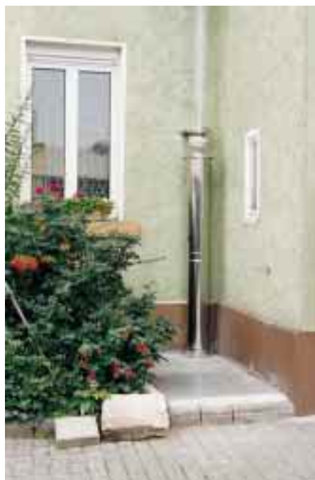
Beispiel einer von der Kluger Schornsteintechnik errichteten außenstehenden „Recusist“-Anlage
