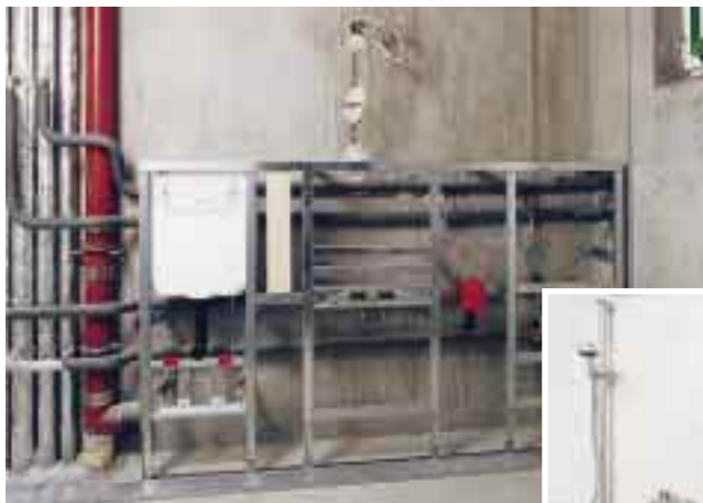
Dank des hohen Vorfertigungsgrades mit Unterstützung des VWI-Systemherstellers konnten die Sanitäreinrichtungen aller Bäder in nur vier Wochen fertiggestellt werden
