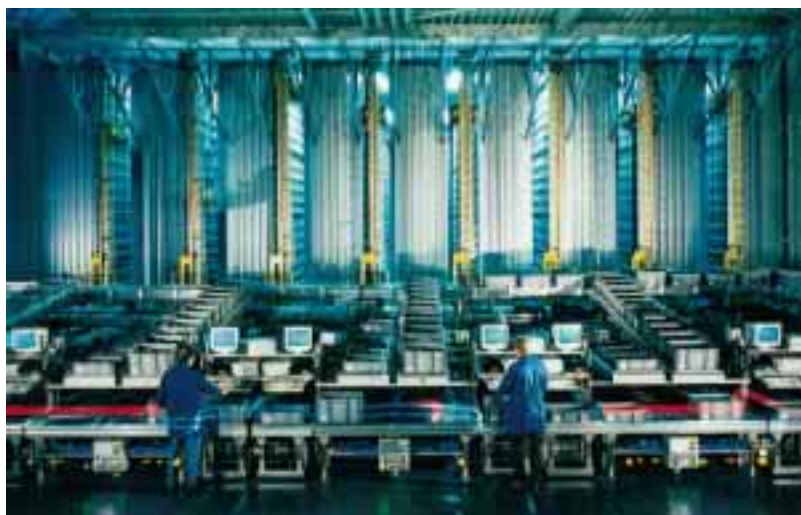
Blick in die Kommissionierzone des automatischen Kleinteilelagers des Weishaupt-Warenverteilzentrums
