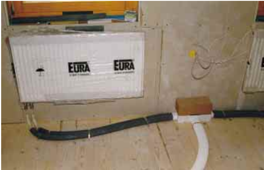
Die Bodendose mit Bauschutzabdeckung und Anordnung der Heizungsvor- und -rückläufe im Fußboden
