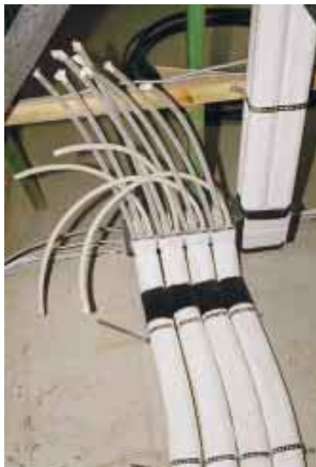
Hauptverteiler mit vier Unterverteilern, wobei der Bauherr den Luftwärmetauscher im Dachgeschloß anordnete
