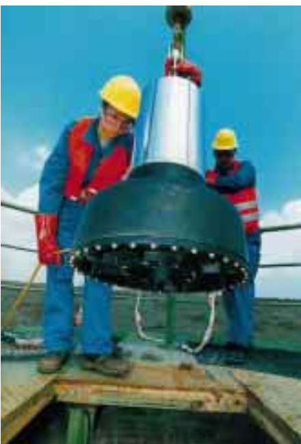
Notfalls können die Pumpen auch von Hand abgesenkt werden
