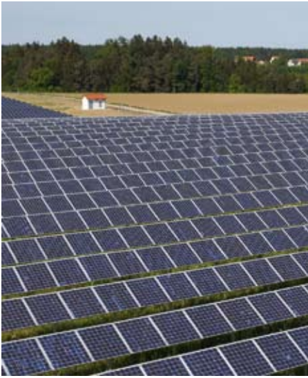
Photovoltaik-Freilandanlagen machen ca. 10 % des Gesamtmarktes aus; hier ist eine 5,3 MWp-Anlage im bayerischen Miegersbach abgebildet
