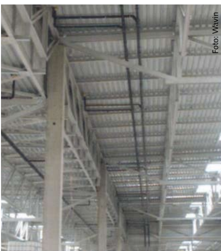
Industrie und Gewerbe: Frei zugängliche Vakuumdruckentwässerung
