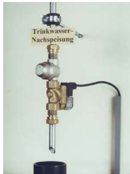
Vorschriftsmäßig: Nachspeisung aus dem Trinkwassernetz mit Magnetventil; der freie Auslauf mit mindestens 30 mm Abstand muss außerhalb des Regenspeichers sein
