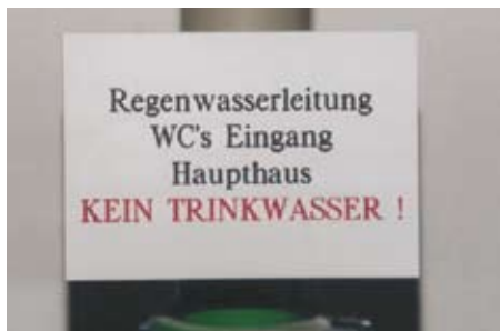
Kennzeichnung: Regenwasserleitungen farblich unterschiedlich zum Trinkwassernetz beschriften!
