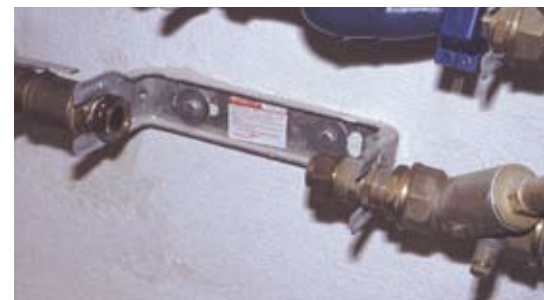
Vorsorge: Zählerbrücke als Platzhalter für den Regenwasserzähler
