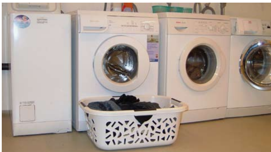
Waschmaschinen: Trinkwasseranschluss zusätzlich zum Regenwasseranschluss. So hat der Nutzer die Wahl
