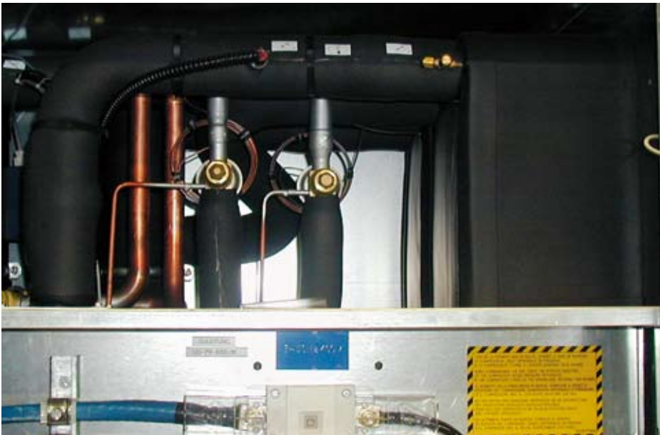
Das Expansionsventil ist im Vergleich zu den anderen Komponenten des Kältekreislaufs eher unscheinbar. Zwei Expansionsventile sind hier nebeneinander im oberen Teil des Bildes zu sehen. Rechts daneben ein Verdampfer in der Bauform eines Platten-Wärmetauschers
