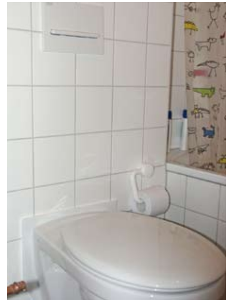
Die WC-Anlagen in den Bädern sind mit der Betätigungsplatte Mepa-Sky ausgestattet
