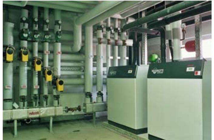
Für geothermische Wärmepumpenanlagen bleibt auch in Zukunft die Befreiung von der Abrechnung der Heizkosten nach erfasstem Verbrauch erhalten
